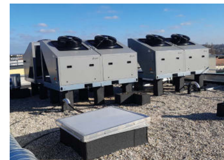
Pompe à chaleur sur plots béton (Crédit : Intuis)
